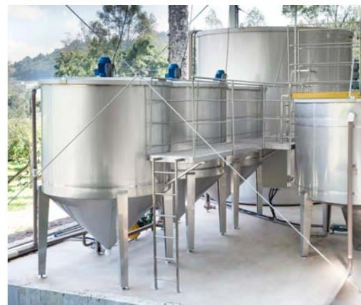
ESTAÇÃO DE TRATAMENTO
