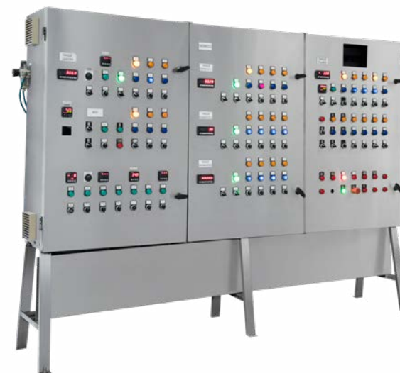
PAINEL DE AUTOMAÇÃO
